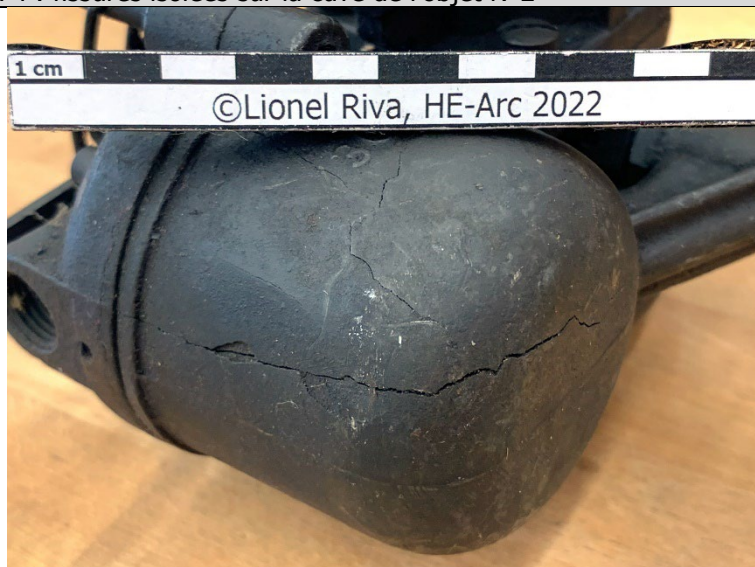
Fig. 74 : fissures isolées sur la cuve de l'objet N°2
